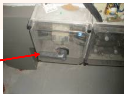
Existen dos interruptores de corte general del edificio Anexo
