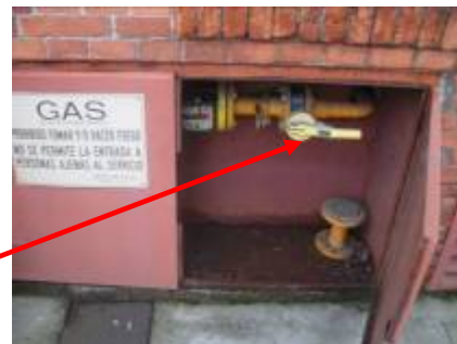
Acometida de gas
