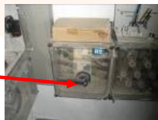
Existen dos interruptores de corte general del edificio Ilgner
